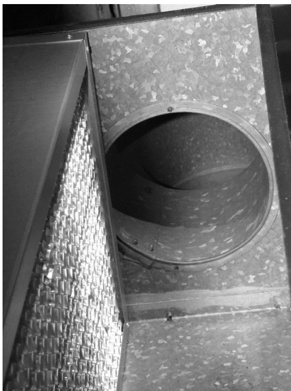
Abbildung 151: Fotodokumentation der Sichtprüfung am Filterkasten
