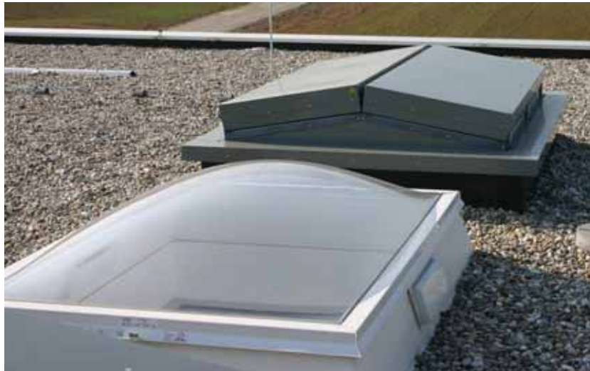
Abbildung 20: Lichtkuppel und RWA-Klappe auf dem Dach der Eingangshalle.
