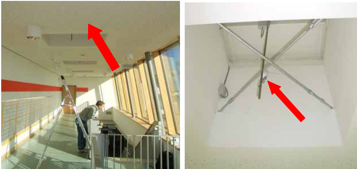
Abbildung 96: Position des Temperaturdatenloggers in der „Dachöffnung“ für die RWA-Klappe im 2. OG der Schule (Westflügel).
