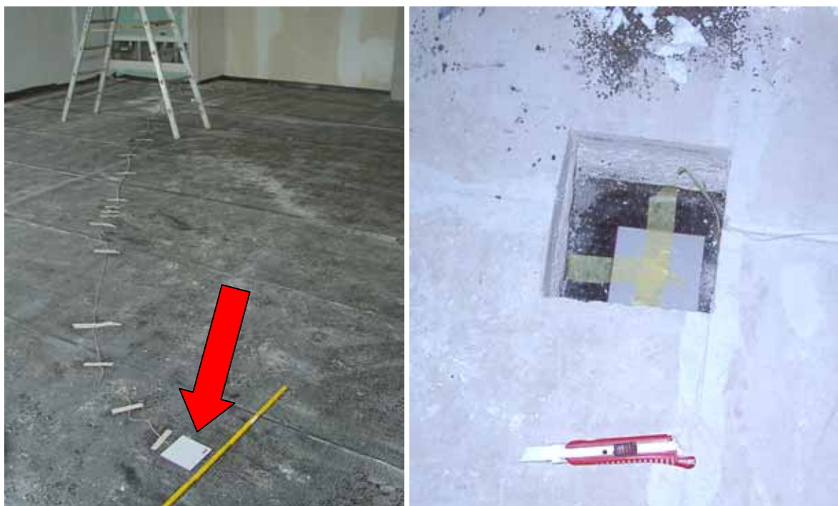
Abbildung 42: Montage der Wärmestrommessplatten in Raum 0.3 (vor dem Einbringen der Dämmung) und im Bodenaufbau im Flur vor Raum 0.3.
