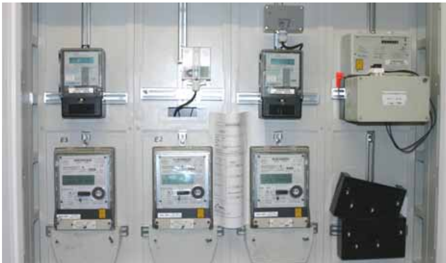
Abbildung 33: Hauptstromzähler und rechts der PV-Einspeisezähler im Hausanschlussraum.
