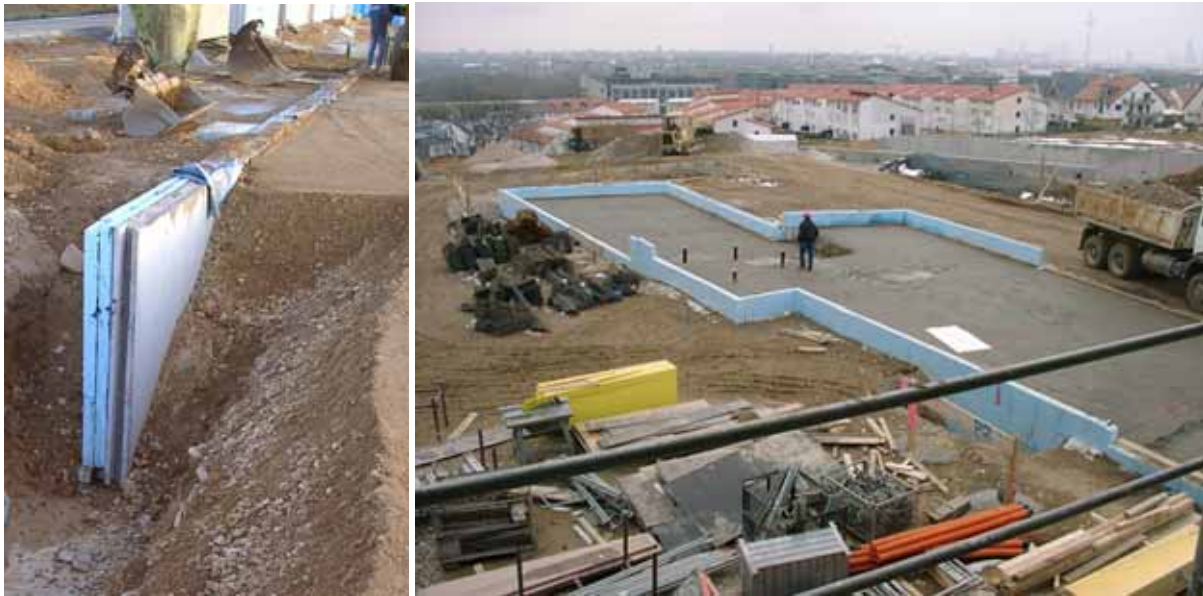
Abbildung 22: Links: Dämmschürze (Betonteil mit 20 cm Dämmstoff). Rechts: Verlängerung der Dämmschürze im Bereich der KiTa mit Blick auf die fertige Sauberkeitsschicht.
