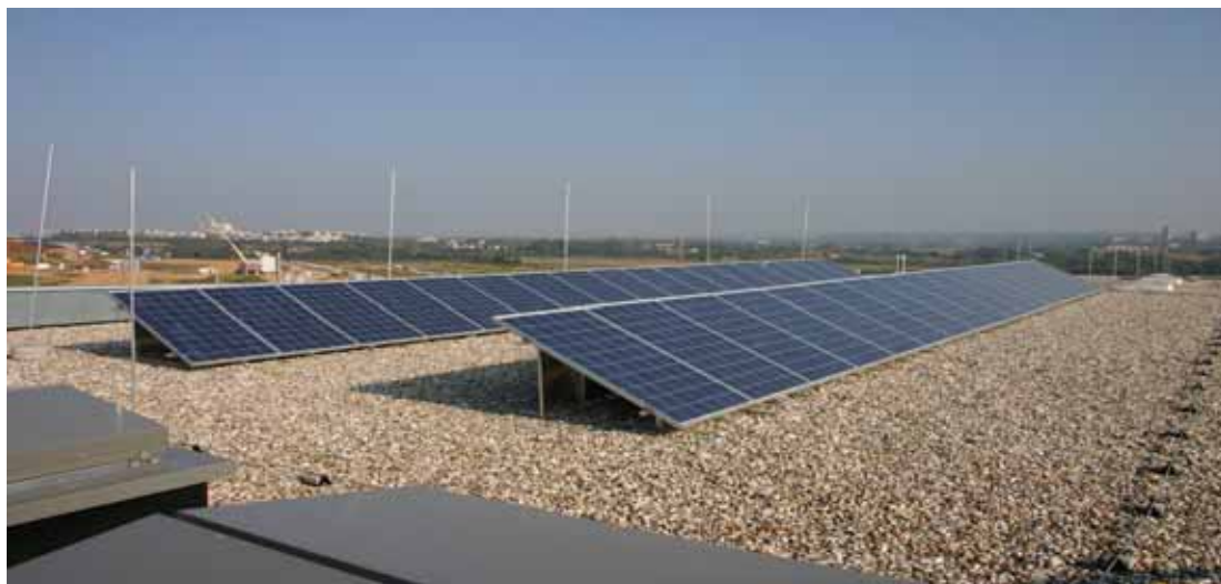
Abbildung 78: PV-Solarstromanlage auf dem Gebäudedach (Nordflügel).
