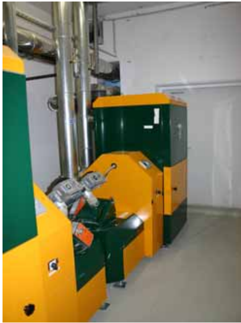
Abbildung 23: Pelletkessel im Heizungsraum.
