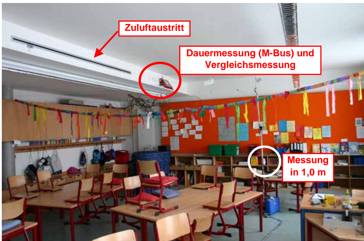
Abbildung 112: Klassenraum mit dem Messständer für die CO 2 -Messungen und der Zuluftöffnung an der Stirnseite der abgehängten Decke.
