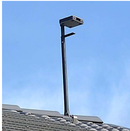
Bild 26: Wetterstation auf dem Dach des 07_HUF HAUS-Gebäudes.
